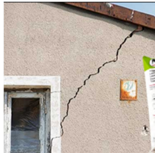
Gambar 13. Retakan karena bangunan tidak menggunakan kolom dan balok praktis (Sumber : www.berita99.co )
